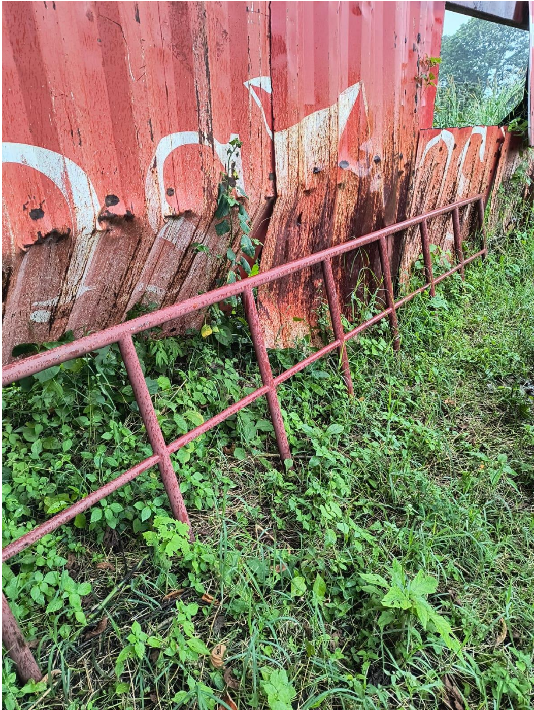
Figura 4.14: desperdicio patio Estructuras CEM
