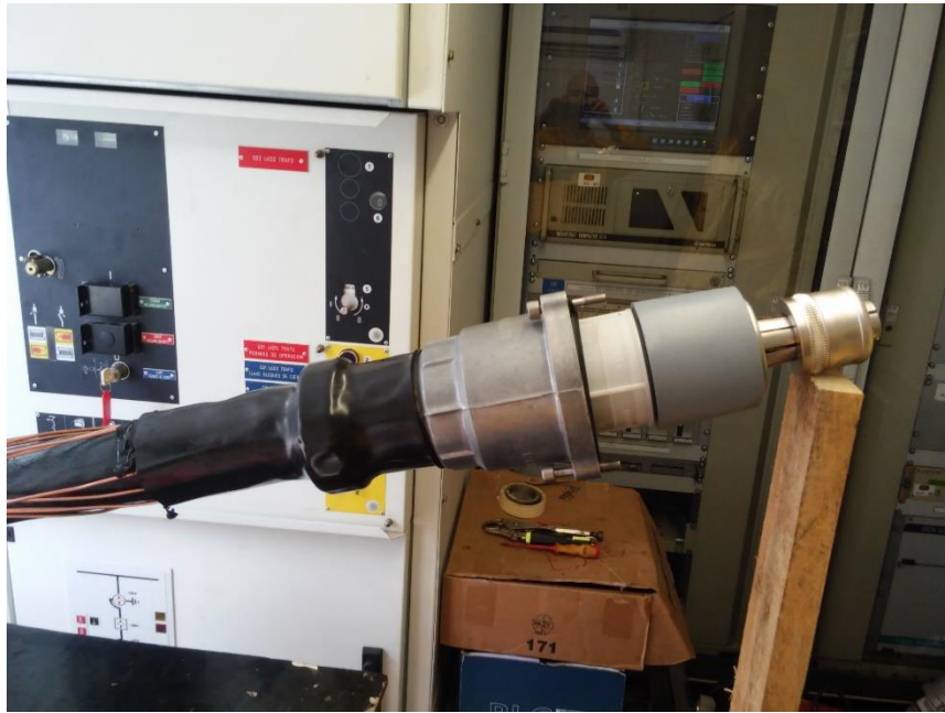
Figura 19. Terminal tipo Pfisterer tamaño 3, 35 kV. Fuente: ICE
