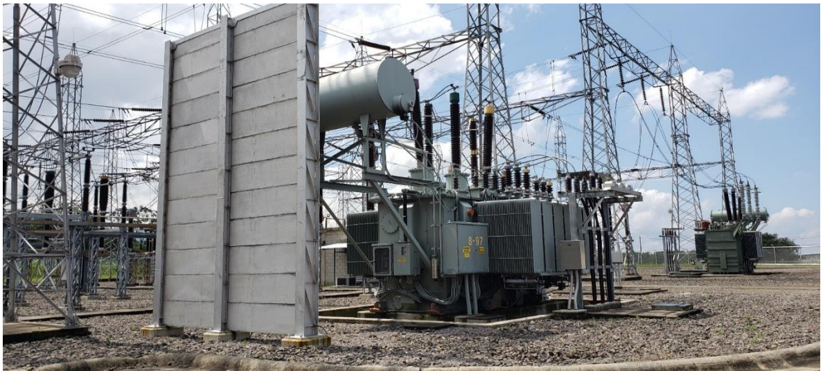
Figura 17. Muro cortafuegos. Fuente: ICE
