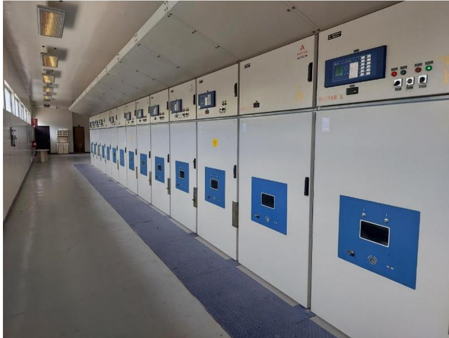
Figura 12. Equipo MT tipo Metal Clad. Fuente: ICE
