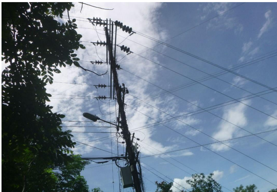
Figura 34. Evidencia de la mala estructura del circuito actual. Fuente propia
