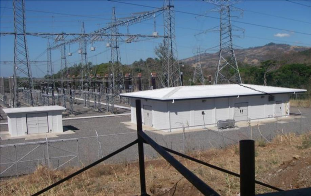
Figura 27. Sala de control o búnker. Fuente: ICE
