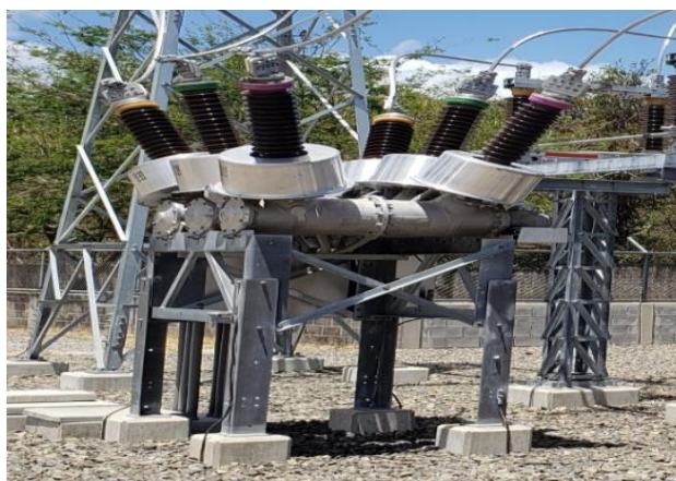
Figura 22. Interruptor de potencia tipo tanque muerto. Fuente: ICE
