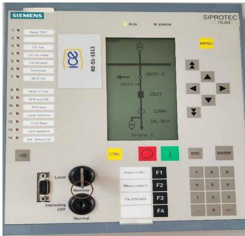
Figura 24. Unidad de protección. Fuente: CNFL
