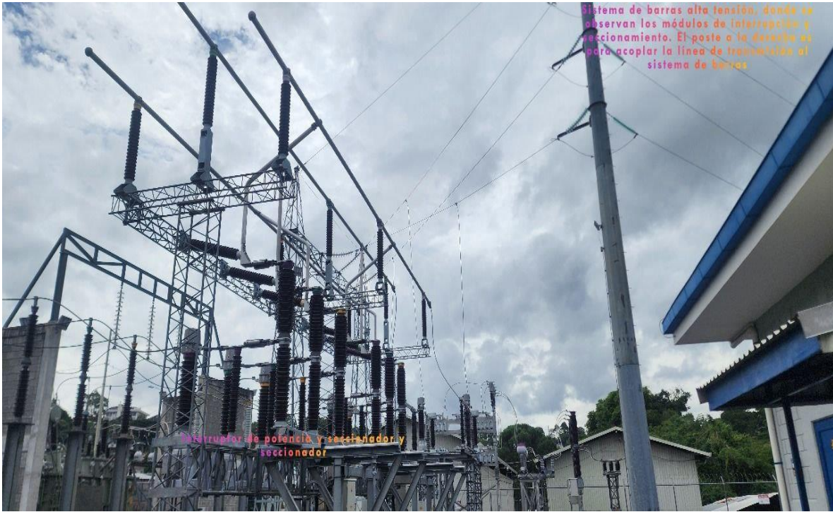
Figura 9. Sistemas de barras de alta tensión. Fuente: CNFL
