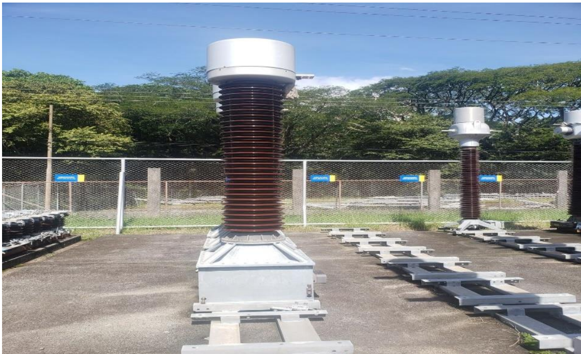
Figura 21. Transformador de potencial 138 kV. Fuente: ICE
