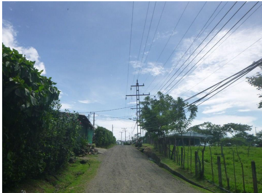
Figura 33. Evidencia de la mala estructura del circuito actual. Fuente propia
