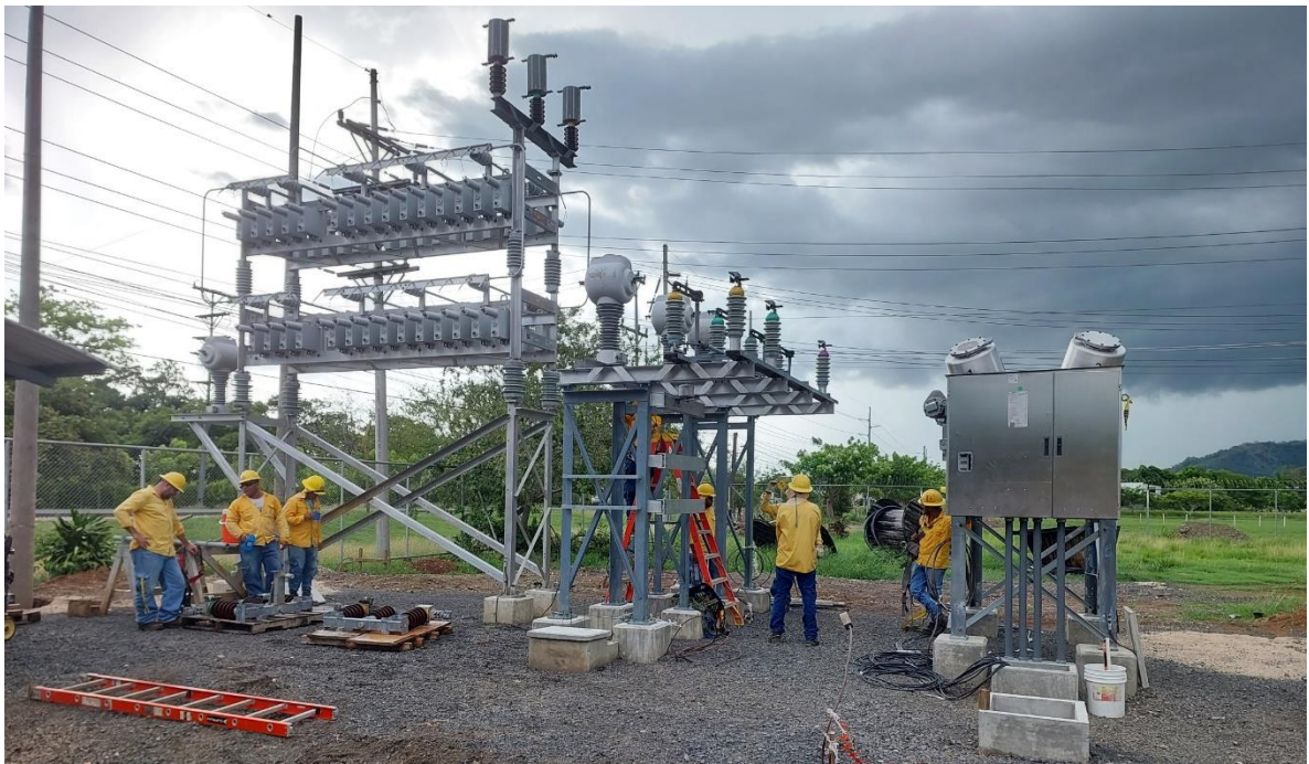
Figura 25. Banco capacitivo en construcción 34,5 kV. Fuente: ICE
