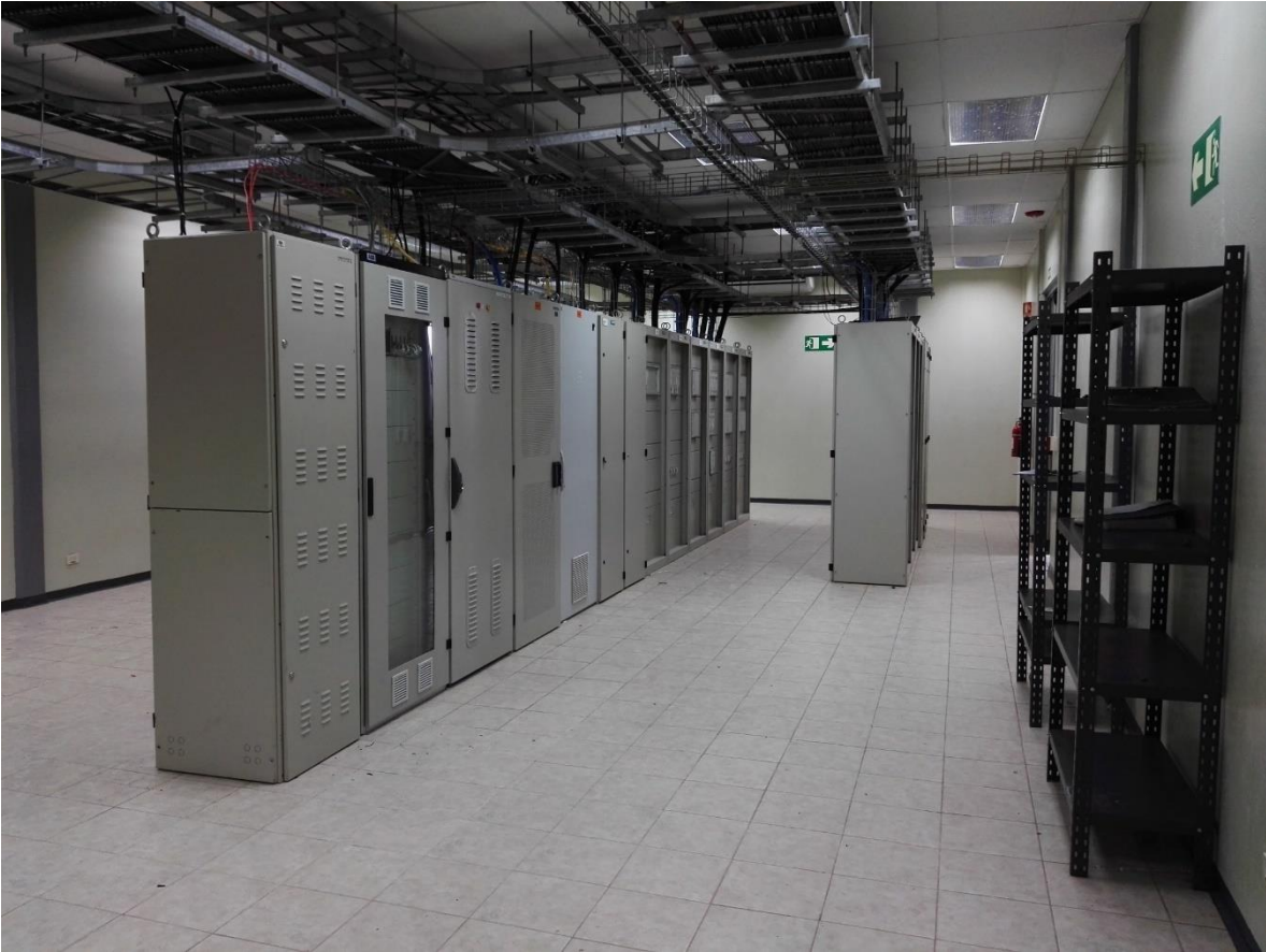
Figura 28. Sala de control. Fuente: CNFL
