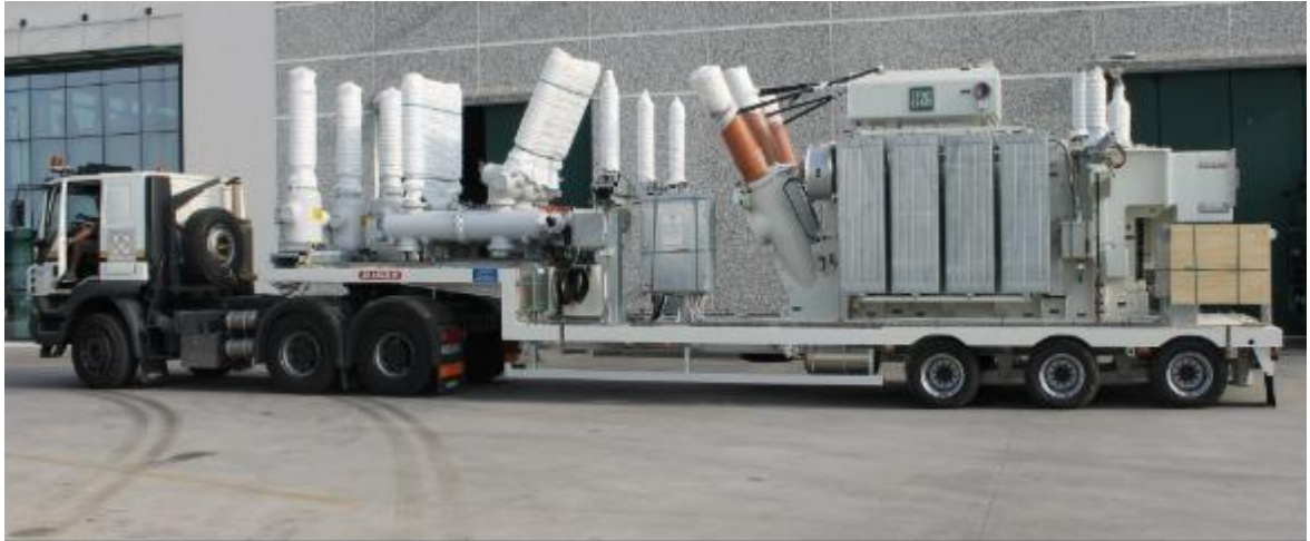
Figura 14.. Subestación móvil. Fuente: Google (2025)
