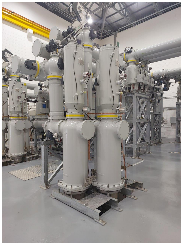
Figura 13. Subestación tipo GIS 230 kV. Fuente: ICE (2025)
