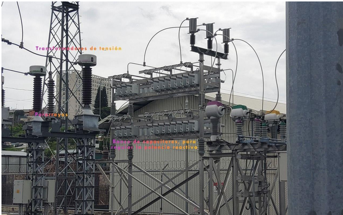
Figura 26. Banco de capacitores. Fuente: CNFL
