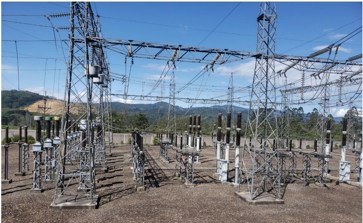
Figura 23. Estructuras mayores y barras colectoras. Fuente: ICE
