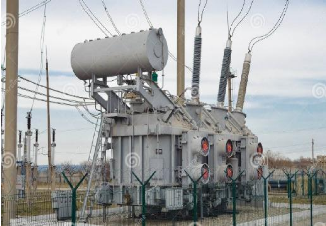
Figura 15. Transformador de potencia. Fuente: Google
