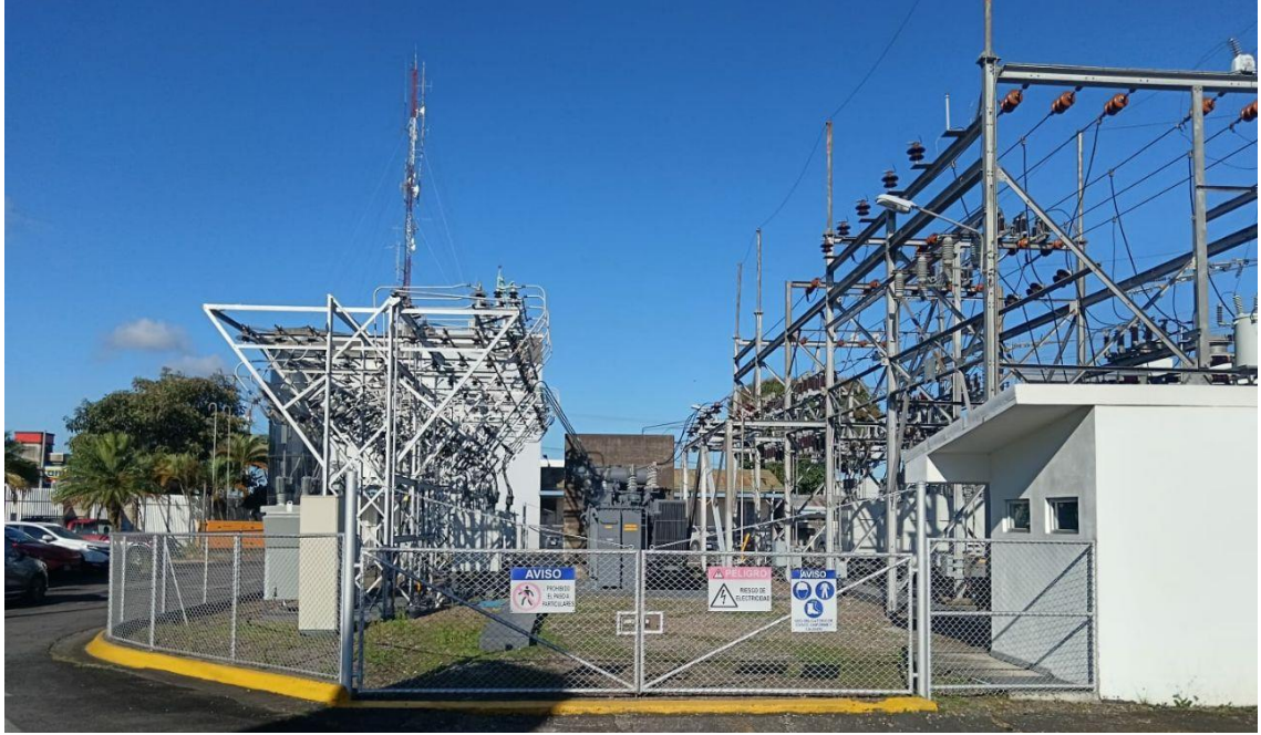
Figura 6. Subestación reductora de 34,5 kV a 13,8 kV ubicada en San José, La Uruca. Fuente: CNFL (2025)
