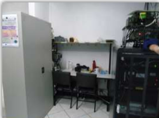
Servidores y cafetín del Centro de Operaciones
