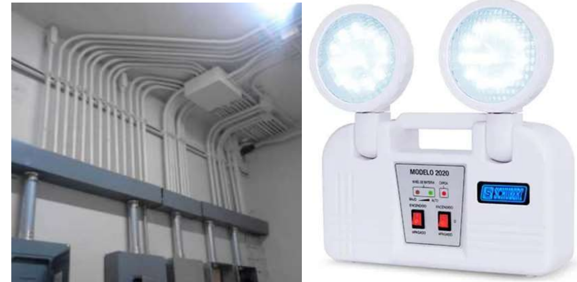
Figura 59 Instalación eléctrica y lámpara de emergencia
