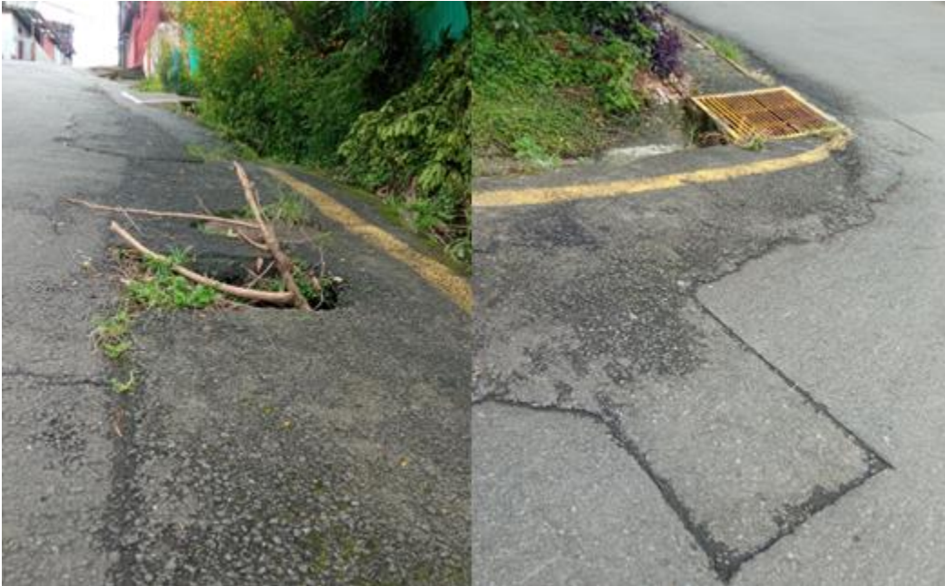
Imagen # 36. Daños en Avenida 29 Fuente: propia, 2022
