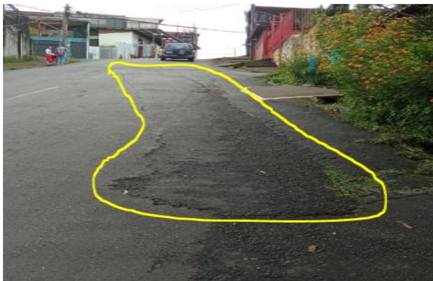
Imagen # 47. Parcheo de asfalto en área de rodamiento, Avenida 29 Fuente: propia, 2022
