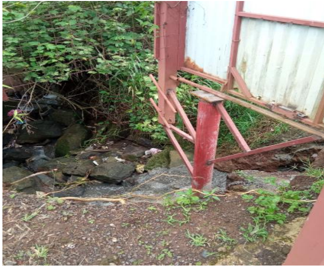
Imagen # 31. Daños de socavamiento con afectación de propiedades colindantes Fuente: propia, 2022
