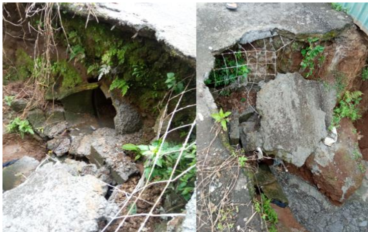
Imagen # 32. Daño en tuberías y características del socavamiento Fuente: propia, 2022
