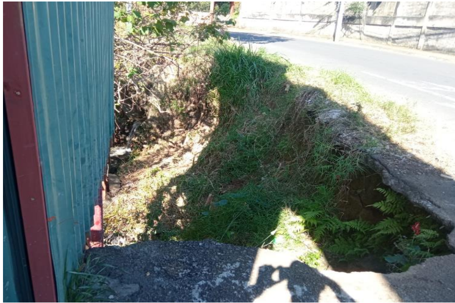
Imagen # 30. Area de socavamiento y desfogue a cause tributario Fuente: propia, 2022
