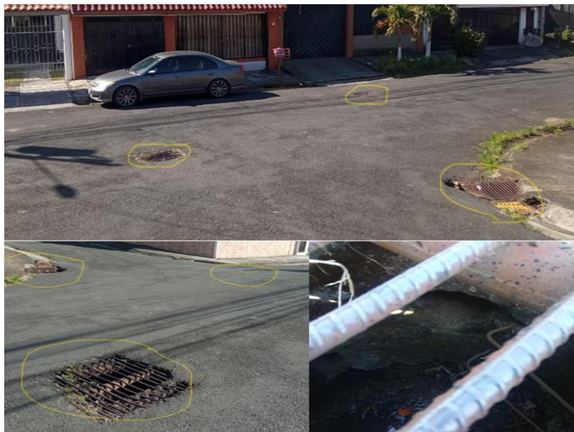
Imagen # 35. Estado de cajas colectoras calle 15 A. Fuente: propia, 2022
