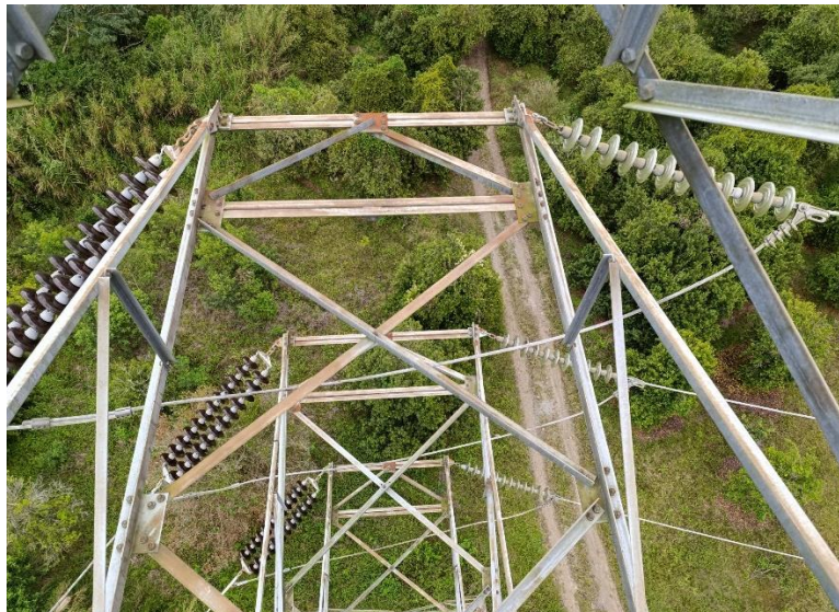
Figura 15: Ménsulas cuadradas con indicios de corrosión
