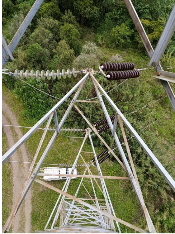
Figura 14: Ménsulas triangulares con indicios de corrosión
