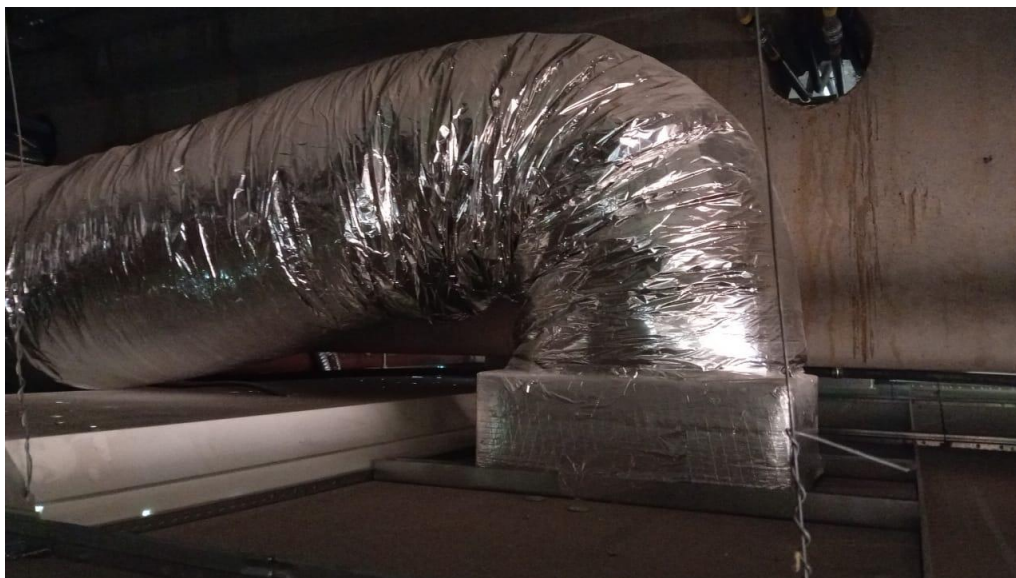
Ductos de Distribución de Aire
