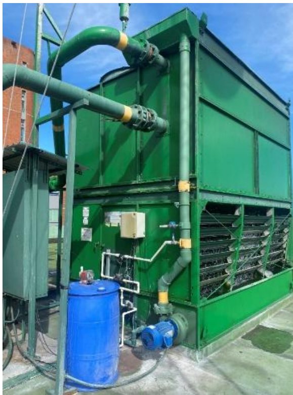
Torre de Enfriamiento del Edificio Torre B
