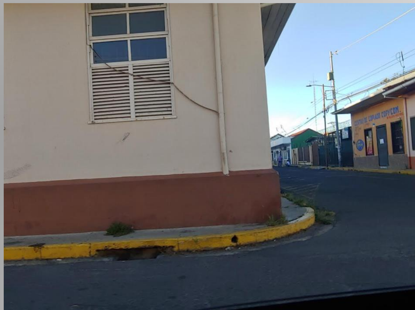
Ilustración 44. Incumplimiento en ancho de aceras y rampas, ley 7600, Liberia centro
