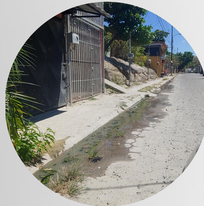
Ilustración 36. Aguas residuales en vía pública, barrio 25 de julio
