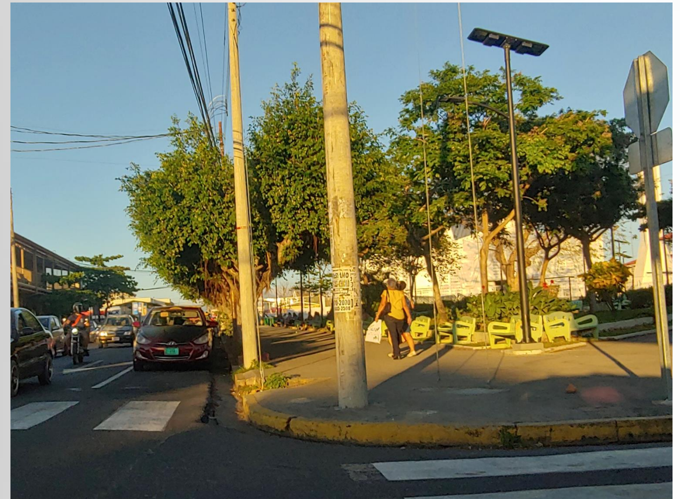
Ilustración 41. Incumplimiento en criterio de diseño rampas 7600, esquina noroeste parque Mario Cañas Ruiz
