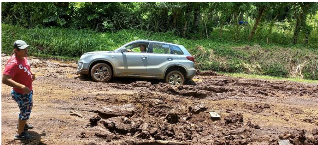
Figura 17, estacionamiento 3+250 estado de la subbase, ruta 160 160 SC 5-0621-00 5-0622-00 y 5-0623-00
