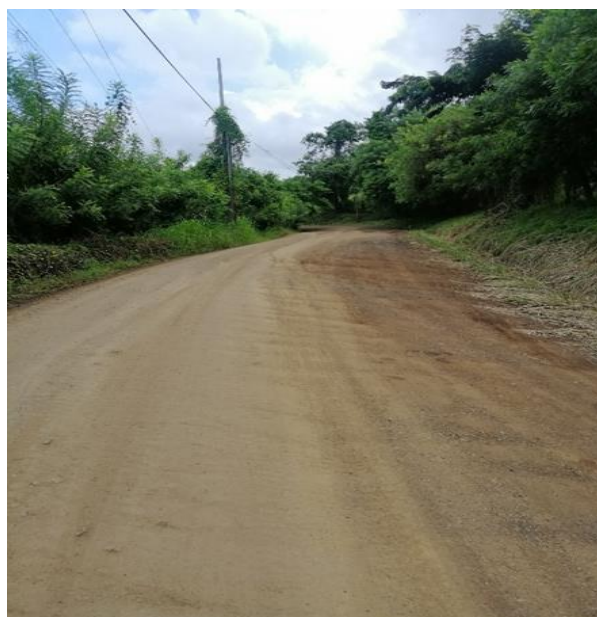
Figura 19. Estacionamiento 13+257 estado de la ruta
