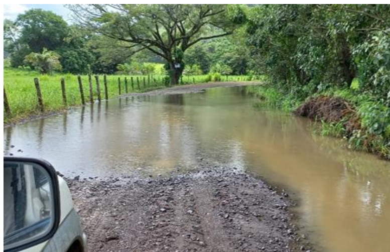
Figura 22. Alcantarilla obstruida entre Javilla y San Francisco Coyote
