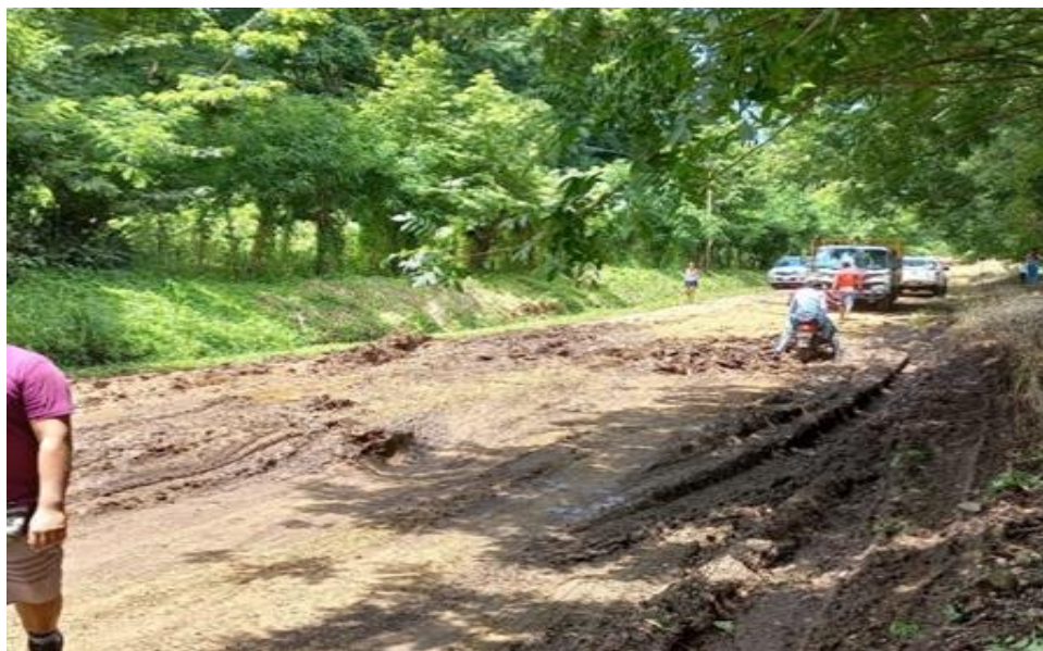
Figura 18. Estacionamiento 3+250 estado de la sub base, ruta 160160 SC 5-0621-00 5-0622-00 y 5-0623-00
