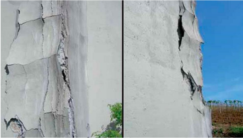
Ilustración 58: Daños por humedad en estructuras de concreto.
