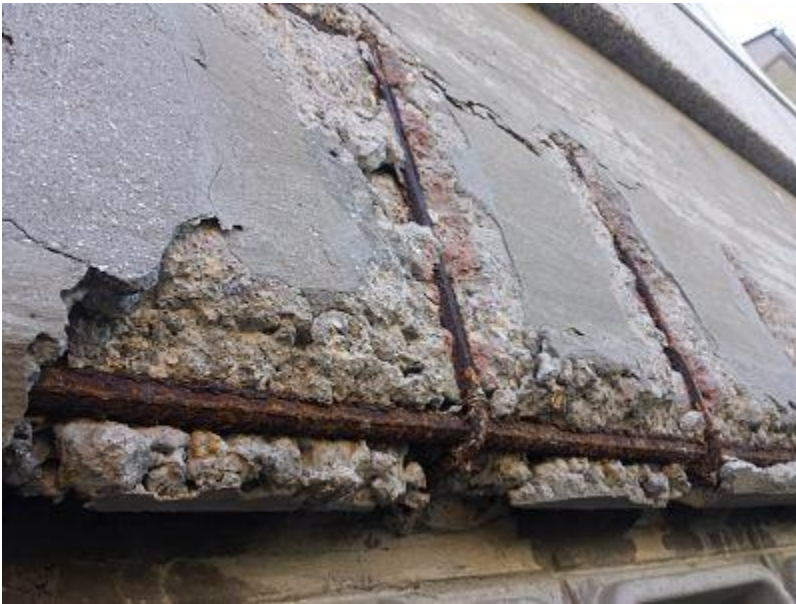
Ilustración 57: Daños por acidez en estructuras de concreto.
