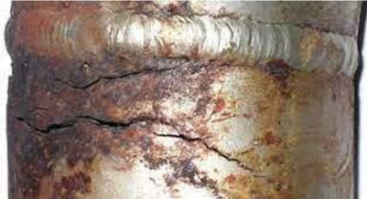
Ilustración 49: Corrosión por fisura.
