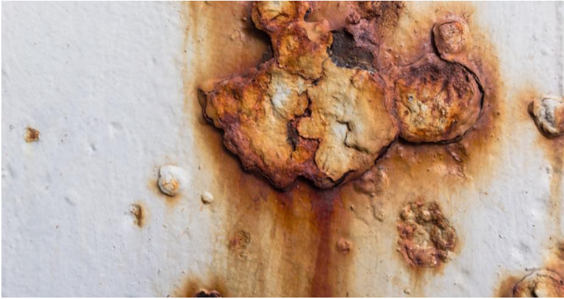
Ilustración 52: Corrosión por microbiología.
