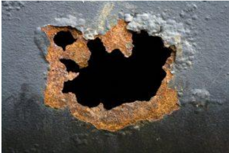
Ilustración 50: Corrosión por picadura.
