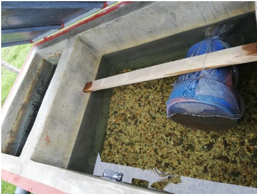
Figura 6. Tanque de salida ASADA de Cascajal
