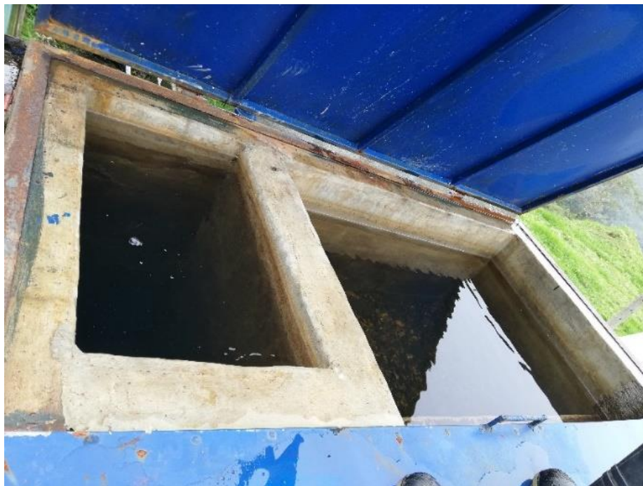
Figura 4. Tanque de almacenamiento ASADA de Cascajal
