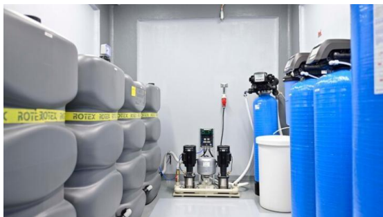
Figura 1. Planta de Tratamiento de Agua Hospital México, Inauguración Noviembre del 2022. Fuente: Rosales, 2022.
