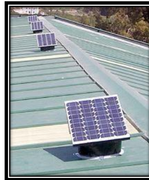
Figura 70: Extractor con panel solar
