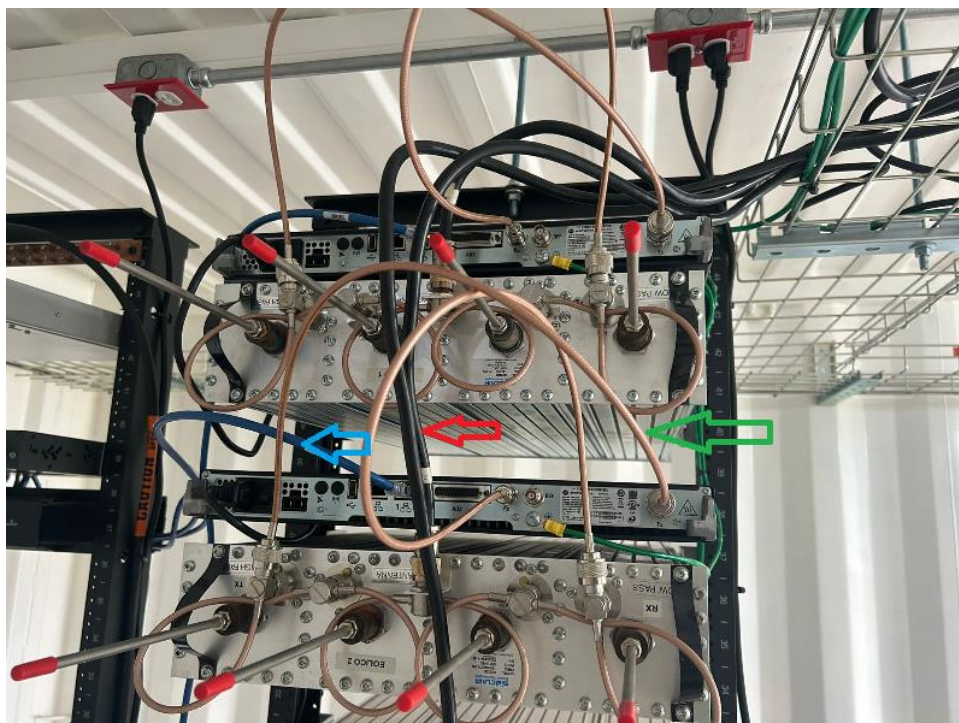
Ilustración 43. Vista trasera, conectividad de cables
