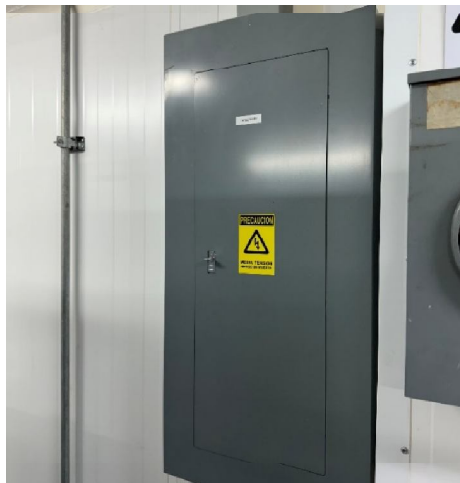
Figura 5.9: Fuente de alimentación n.º 2 dentro del Laboratorio
