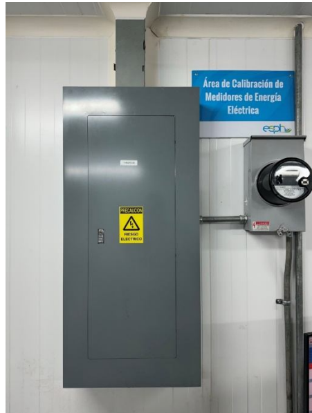
Figura 5.8: Fuente de alimentación n.º 1 dentro del Laboratorio
