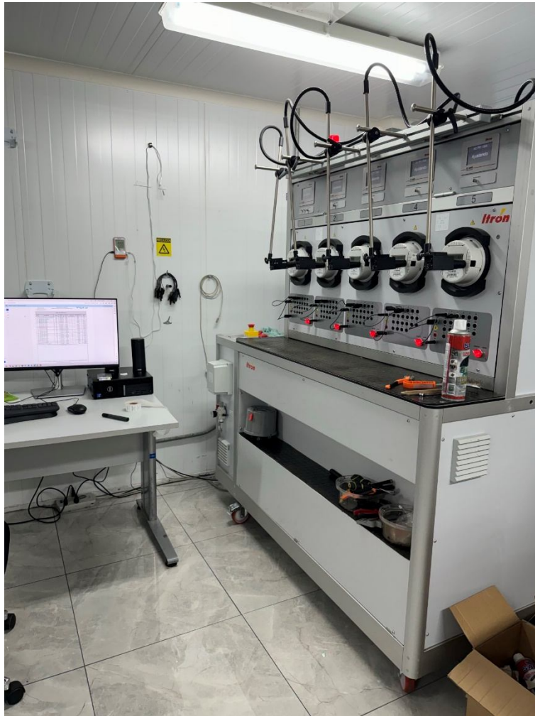
Figura 5.6: Banco de calibración de medidores de energía eléctrica
