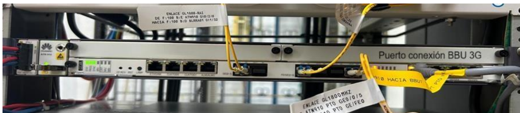
Figura 29 Puerto conexión BBU 3G en módulo ATN
