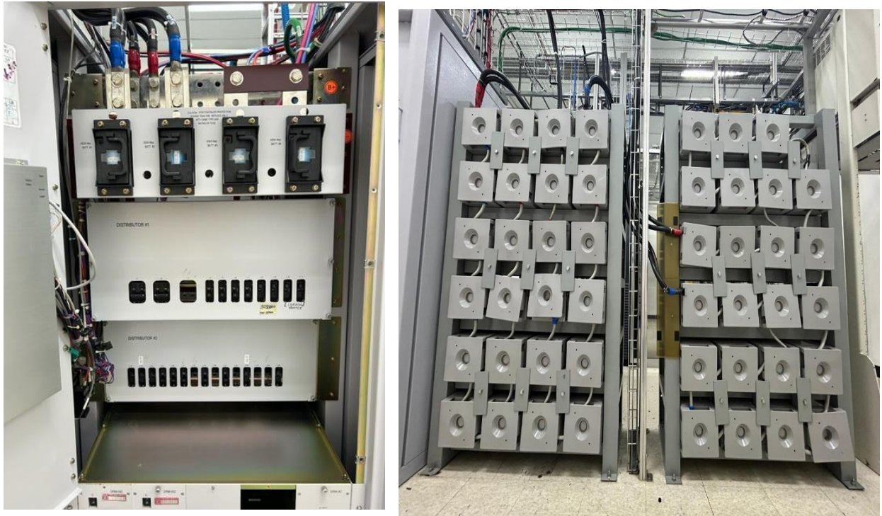
Figura 27 Equipo rectificador Dongah y banco baterías respaldo
