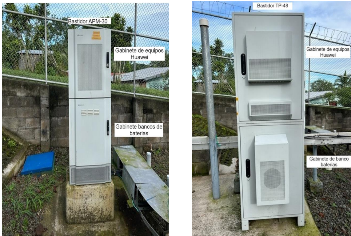
Figura 25 Bastidores de equipos APM-30 y TP-48
