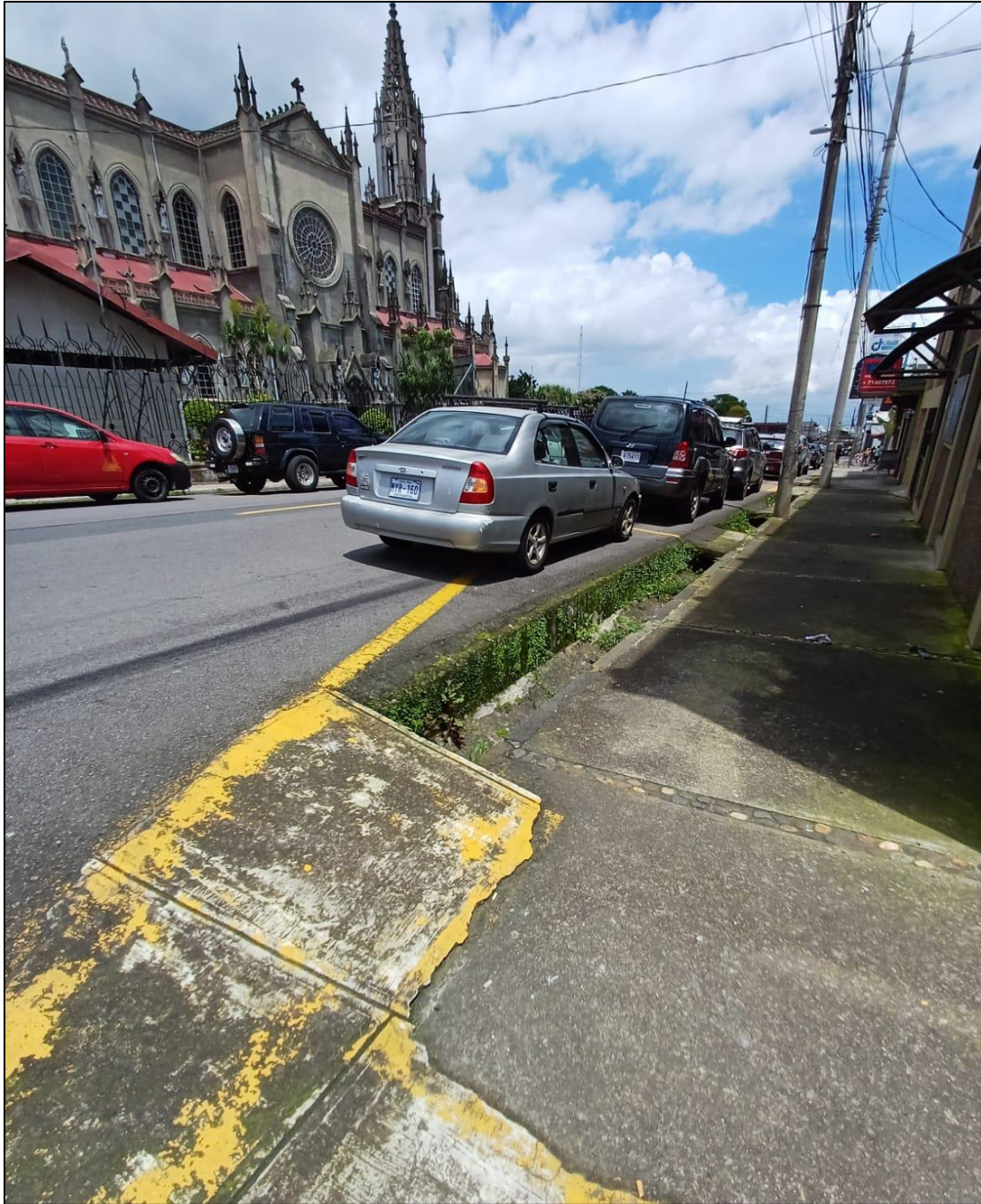
Figura 11. Estado de la acera en sector norte a la iglesia Fuente: Elaboración propia
