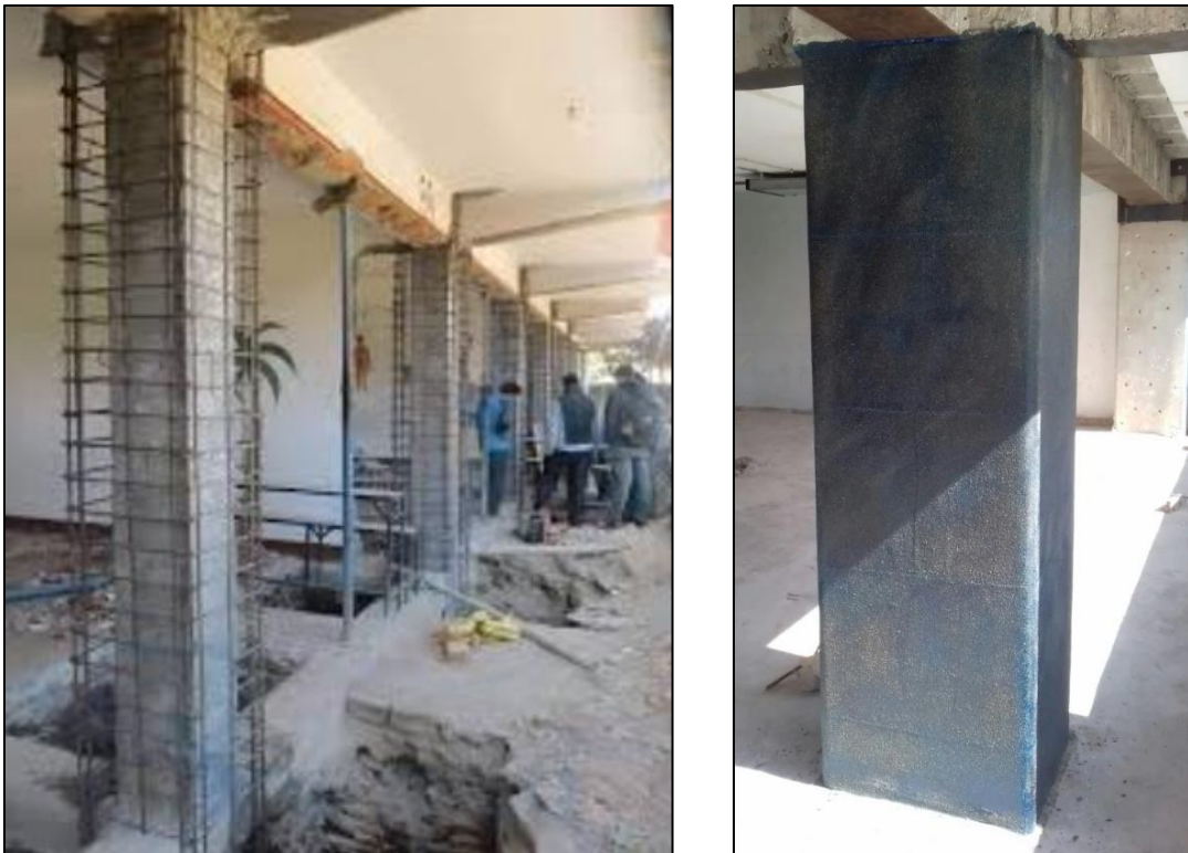
Figura 38. Reforzamiento de columnas con camisas de acero y fibras de carbono Fuente: Elaboración propia
