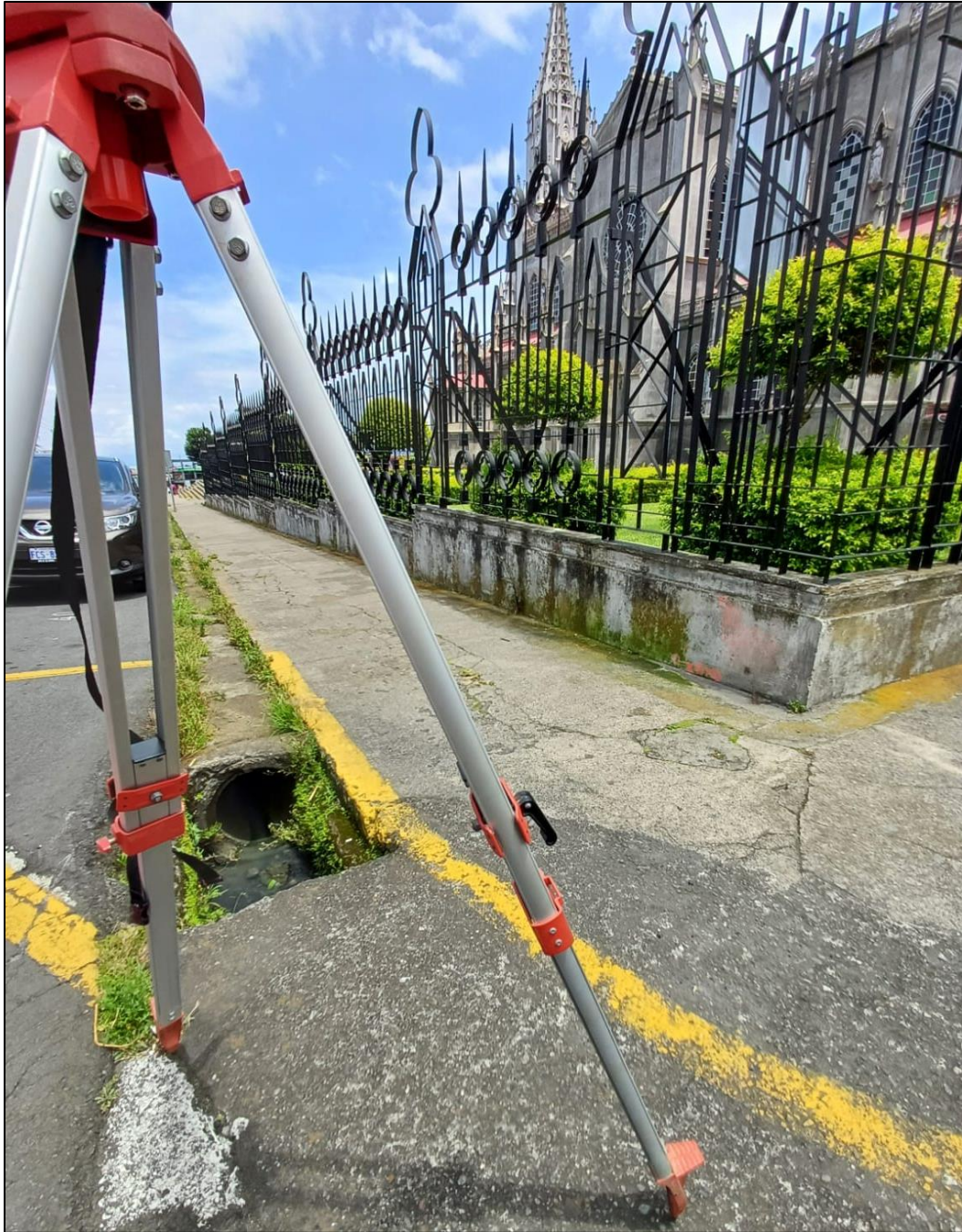
Figura 12. Estado de la acera en sector sur a la iglesia Fuente: Elaboración propia
