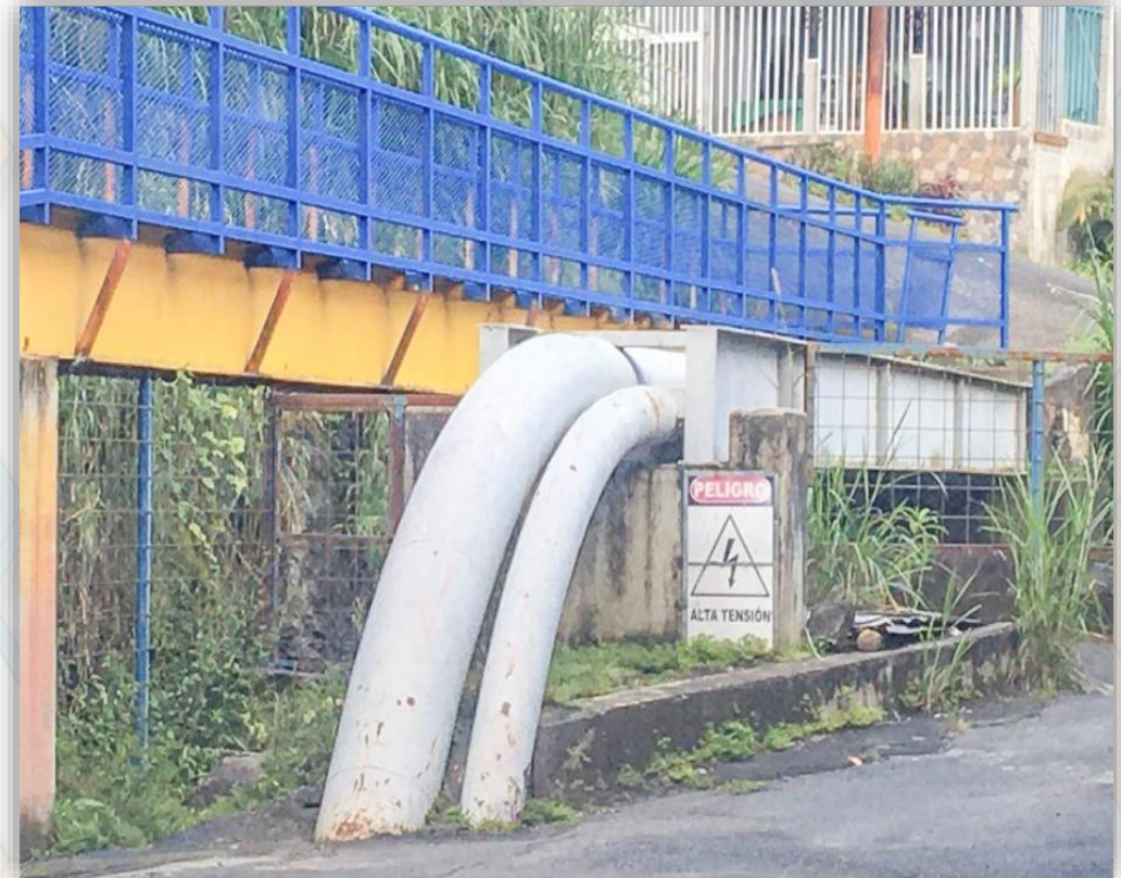
Imagen 44. Puente peatonal y parte del tendido subterráneo de la conexión de media tensión proveniente de la subestación la Uruca, en calle Diagonal 39. Fuente: elaboración propia
