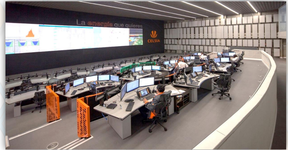
Imagen 35. Ejemplo sala de control. Centro de Control CELSIA NOVA, Colombia. Fuente: Internet
