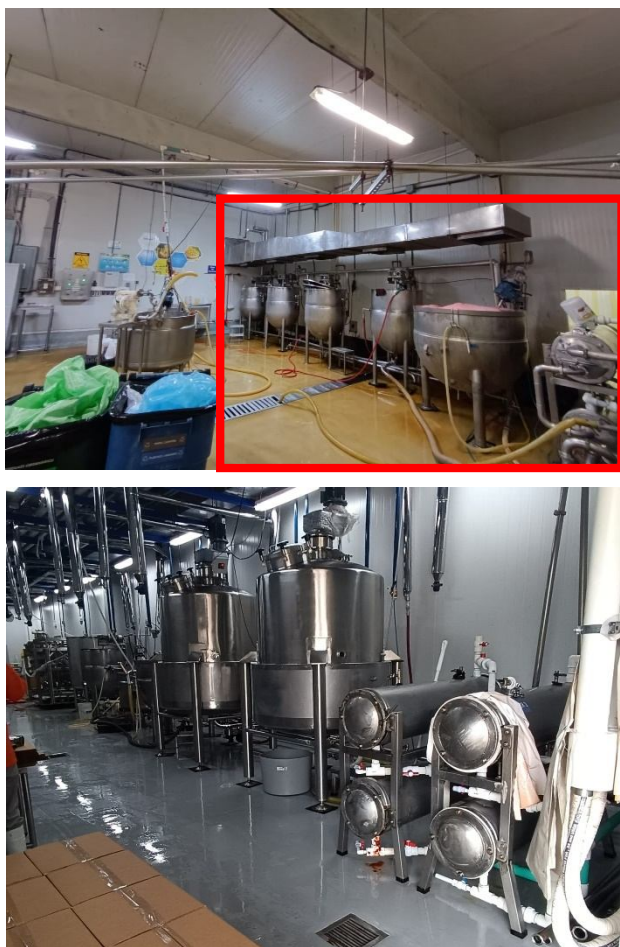
Figura 5.3: Área de cocina 1 antes y después de la integración de la maquinaria
